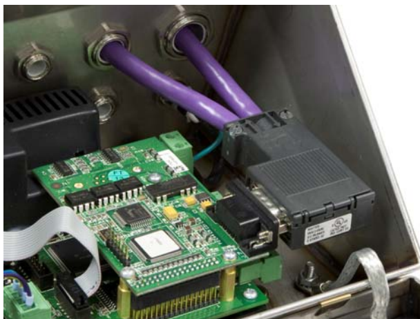
Abbildung 2-61: PROFIBUS-Kabelführung für das Gehäuse für raue Umgebungen
