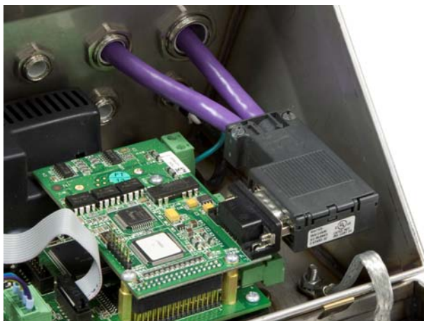
Figura 2-61: Instradamento del cavo PROFIBUS con armadietto per ambienti difficili
