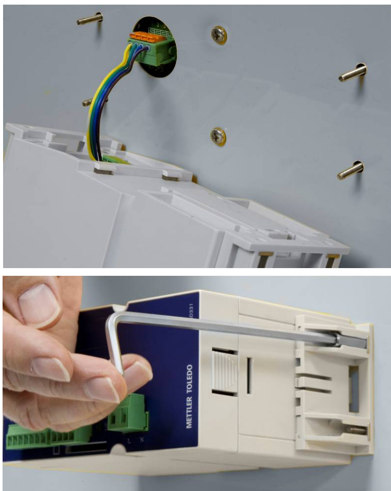
Figura 2-14: Instalación del módulo DIN
